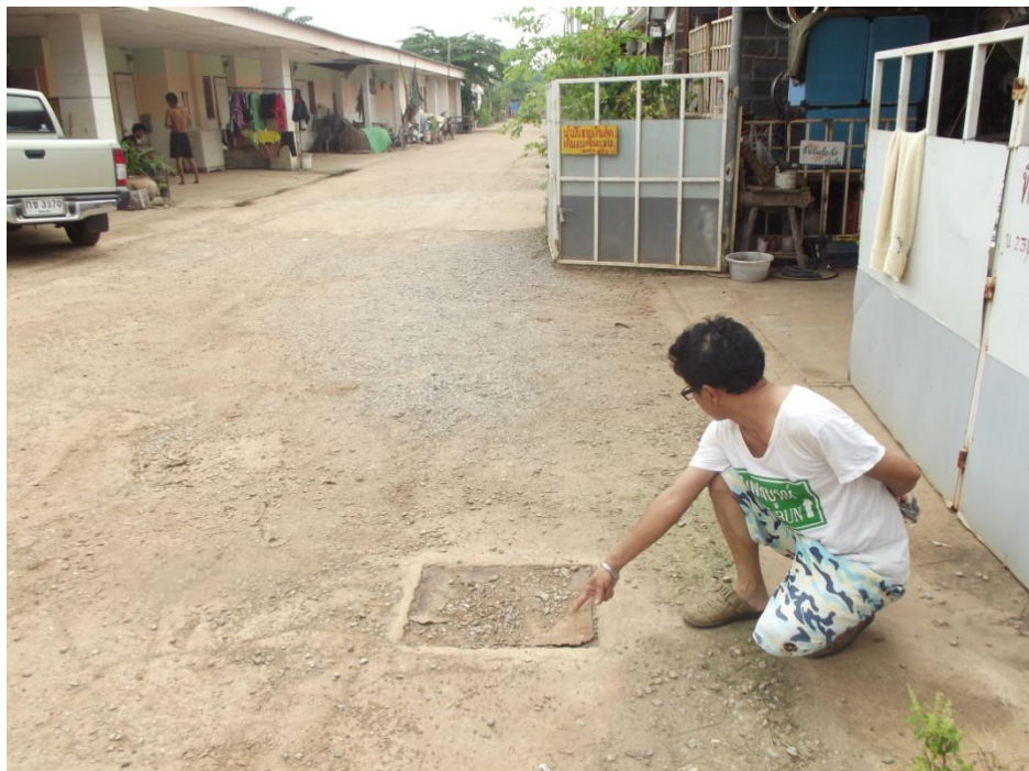
รูปที่ 5.3 ท่อระบายน้ำทิ้งภายในหมู่บ้านชัยจินดา
